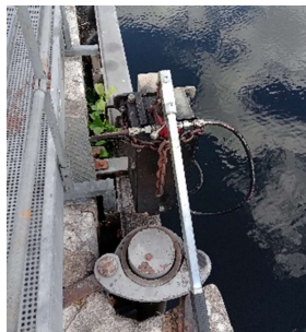
Manoeuvre des vannes
